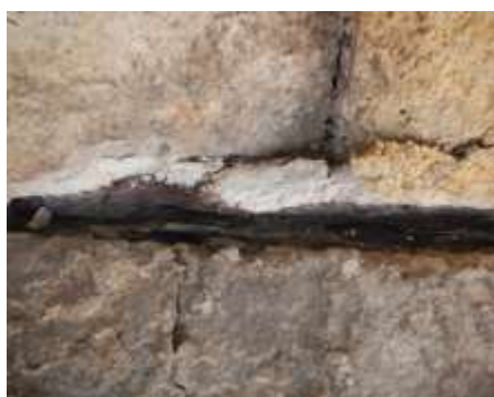
Fig. 8. Zonă degradată ca urmare a expansiunii scoabelor din fier la fațada de vest (V. Ștefan, 2016).
