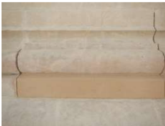
Fig. 11. Reîntregire volumetrică - detaliu de pe fațada principală, unde au existat fisuri adânci termogene (V. Ștefan, 2016).
